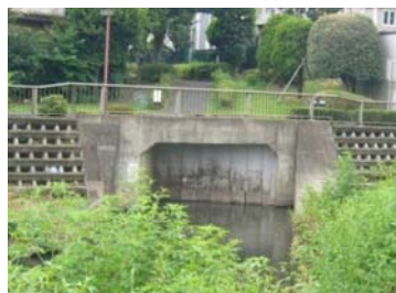
越流水放流渠 きよ (世田谷区)
